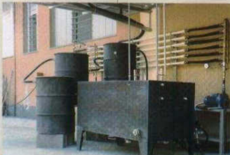
Impianto di ultrafiltrazione e trattamento acque.
